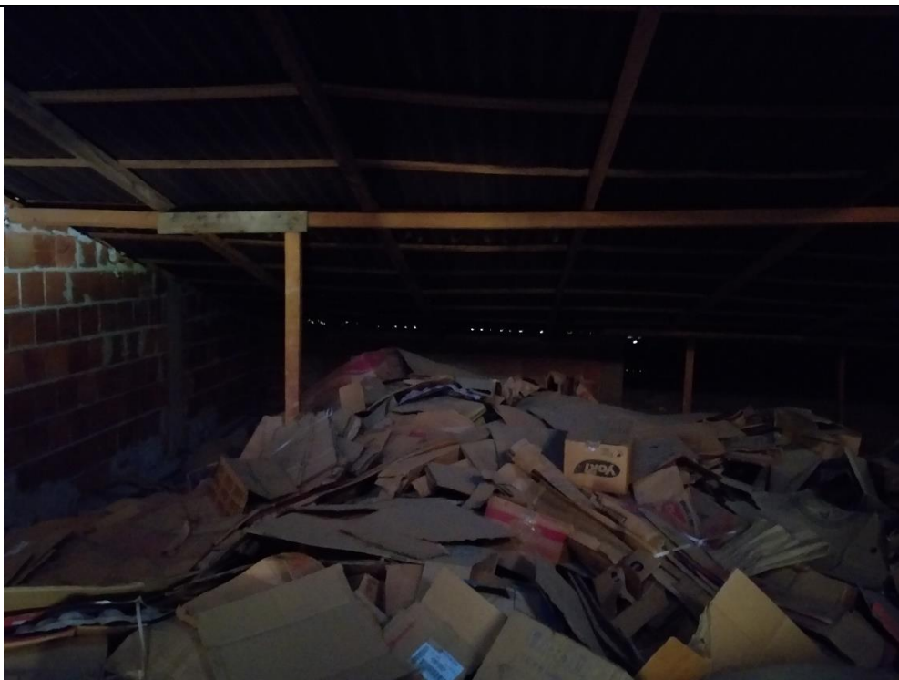
Foto 4 - Portaria do CSE: Detalhe cobertura Madeiramento: flechas das ripas, emendas inadequadas na terça e espaçamento de pontalotes inconsistente
