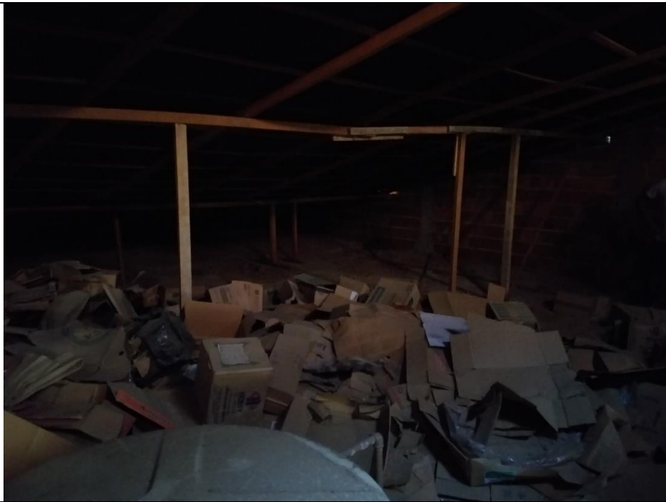
Foto 3 - Portaria do CSE: Detalhe cobertura Madeiramento: Emenda inadequada na terça e espaçamento de pontalotes inconsistente
