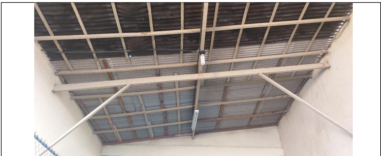
Foto 2 - Portaria do CSE: Detalhe da cobertura Parte da edificação que apresenta telha vã
