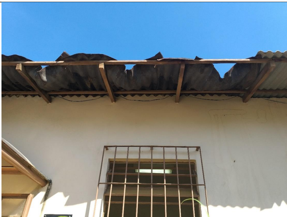
Foto 25 - Unidade de Saúde do Conjunto de Cariacica: Detalhe da cobertura Deformações das telhas
