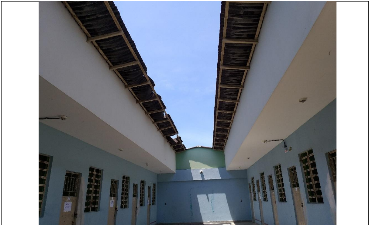
Foto 14 - CSE: Detalhe cobertura das Moradias “Compartilhar” Deformações das telhas
