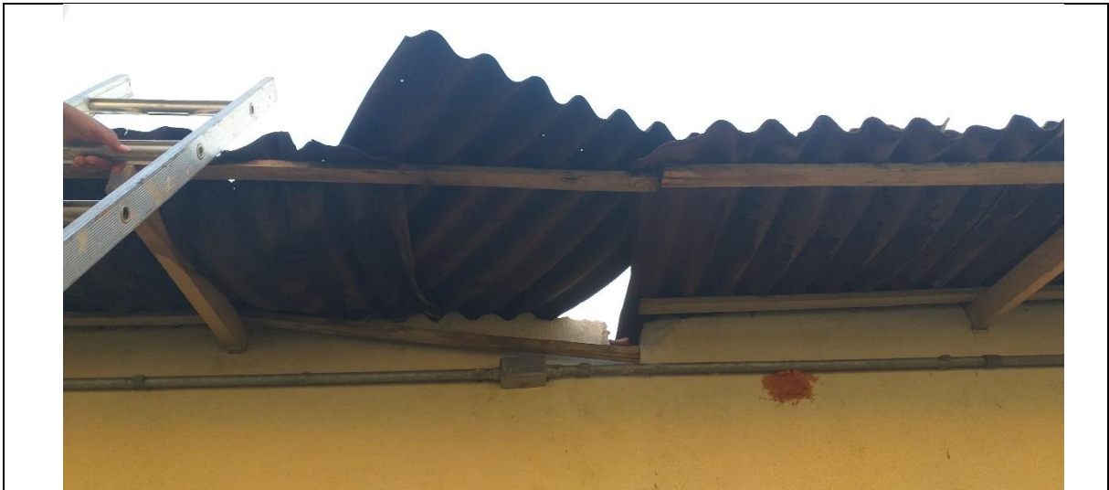
Foto 9 - CSE: Detalhe cobertura da Acolhida 02 Ripas danificadas
