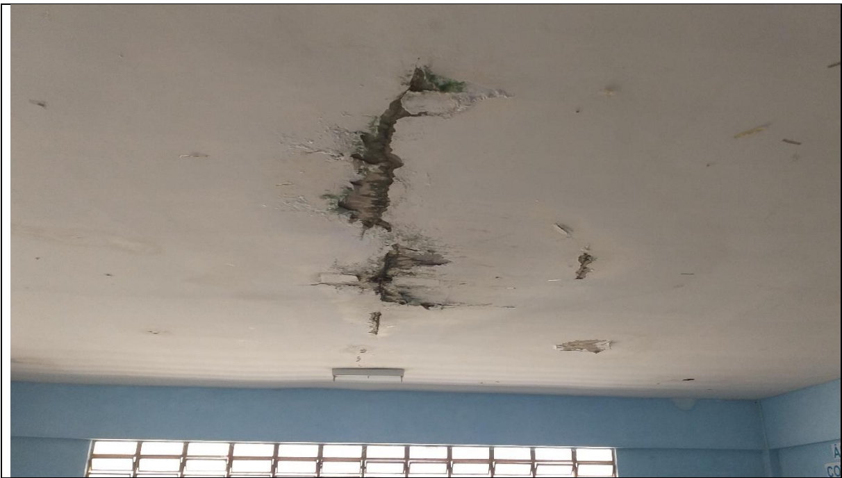
Foto 22 - CSE: Detalhe infiltração interna às moradias
