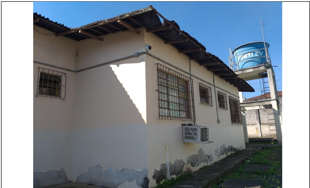
Foto 26 - Unidade de Saúde do Conjunto de Cariacica: Detalhe da cobertura Deformações das telhas
