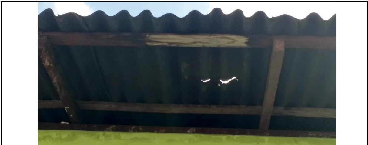
Foto 29 - UNIP II: Detalhe da cobertura Danos das telhas
