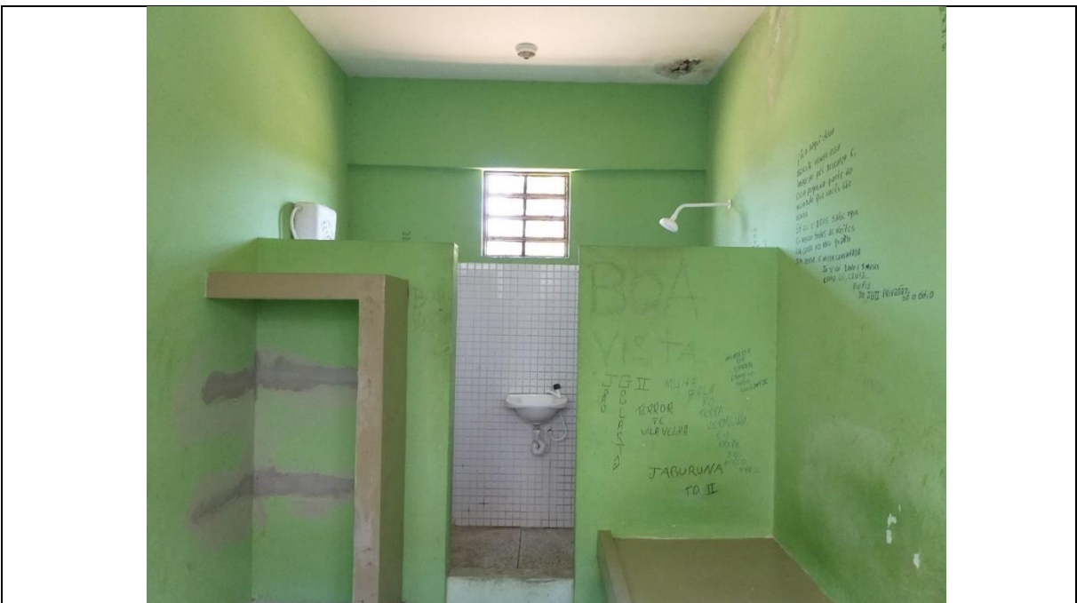
Foto 21 - CSE: Detalhe infiltração interna às moradias
