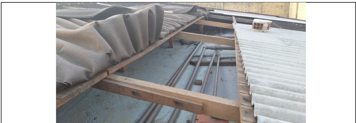
Foto 11 - CSE: Detalhe cobertura da Acolhida 02 Deformações das telhas e emenda em caibro
