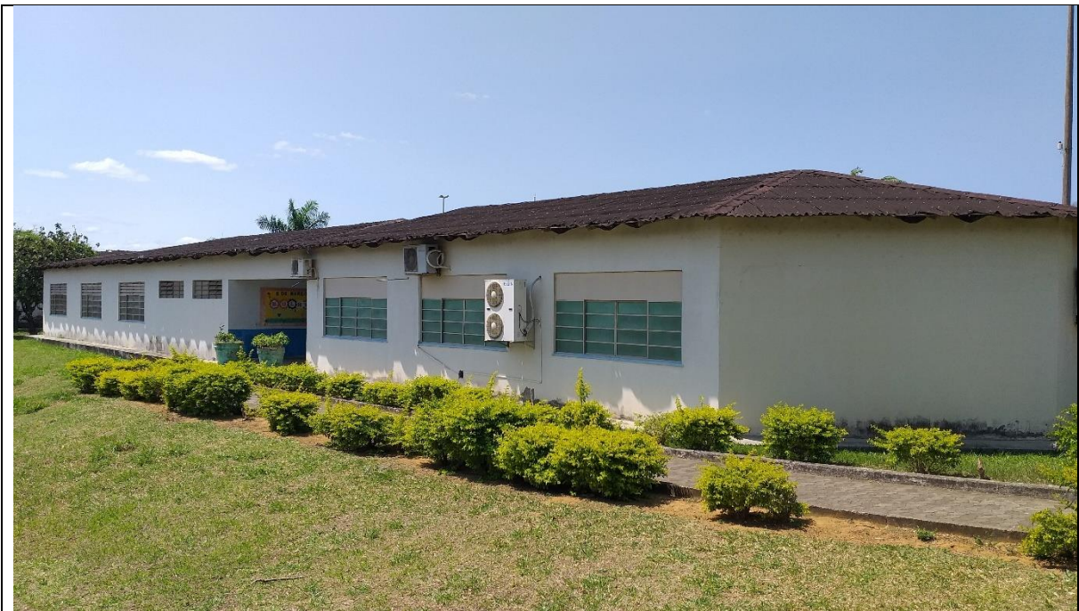
Foto 20 - CSE: Vista Geral da Educação Deformação das telhas
