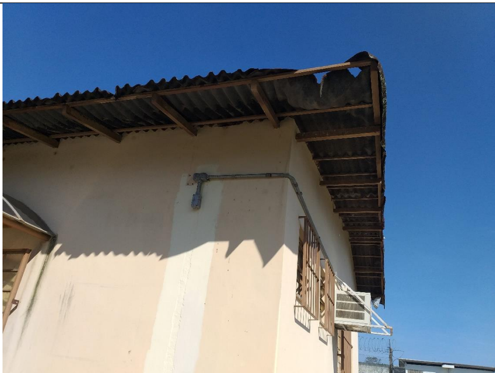
Foto 24 - Unidade de Saúde do Conjunto de Cariacica: Detalhe da cobertura Deformações das telhas
