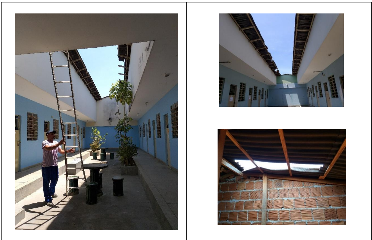
Foto 15, 16 e 17 - CSE: Detalhe cobertura das Moradias “Compartilhar” Deformações das telhas
