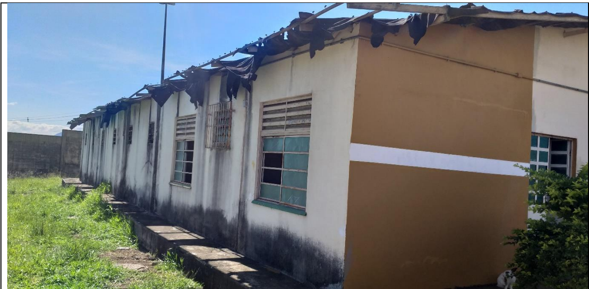
Foto 5 - CSE: Detalhe cobertura da Acolhida 02 Deformação das telhas
