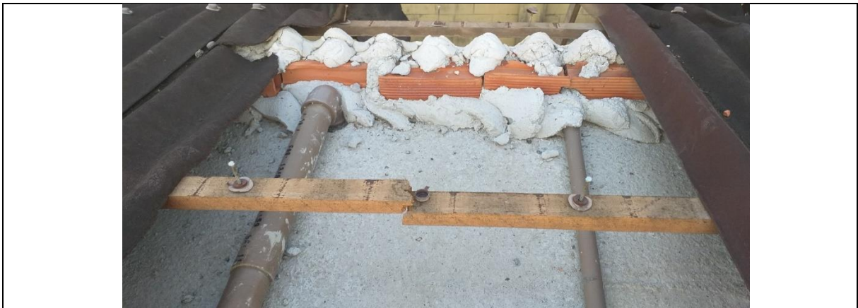
Foto 10 - CSE: Detalhe cobertura da Acolhida 02 Ripas danificadas
