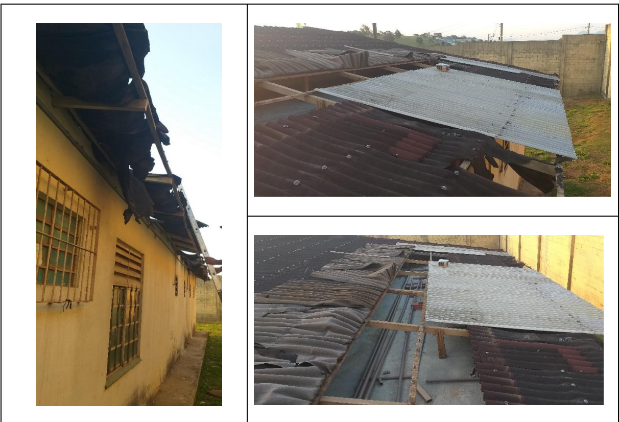
Fotos 6, 7 e 8 - CSE: Detalhe cobertura da Acolhida 02 Deformações das telhas
